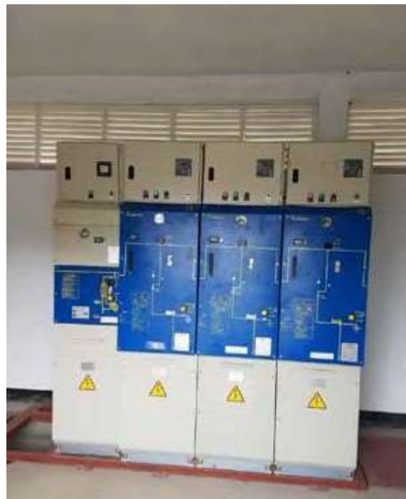
Cellules 36 KV de la SOCODEE
