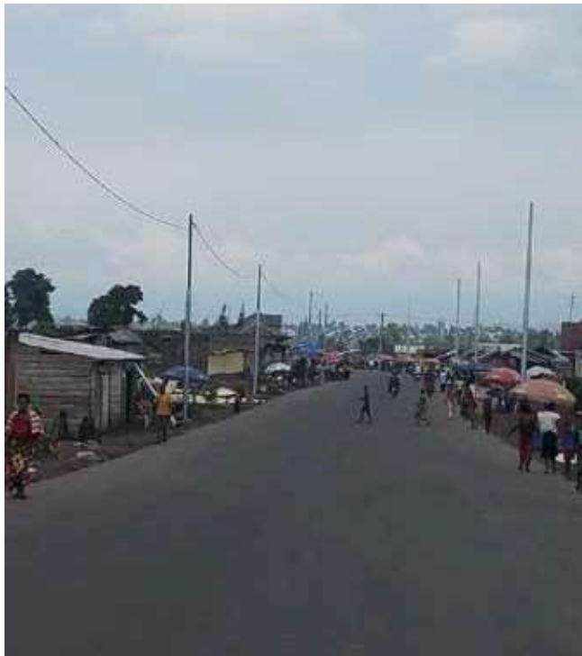
Réseau BT en torsadé isolé de 70mm 2
